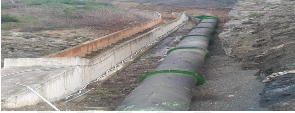
Şekil 2. 12. Cebri boru ve drenaj alanı 5
