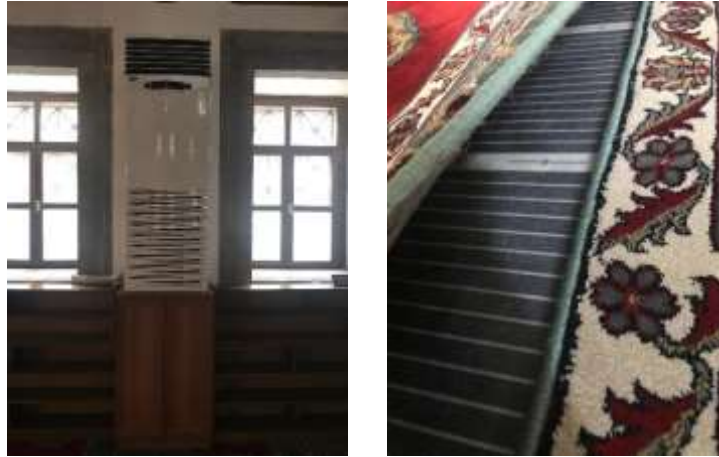
Şekil 28. Çarşı Cami ısıtma ve soğutma ekipmanı görselleri
