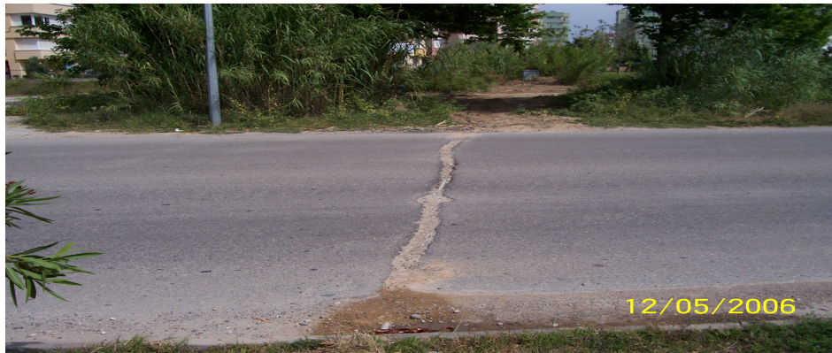
Şekil 26. Bölge yollarında tespit edilen bozulmalara bir örnek
