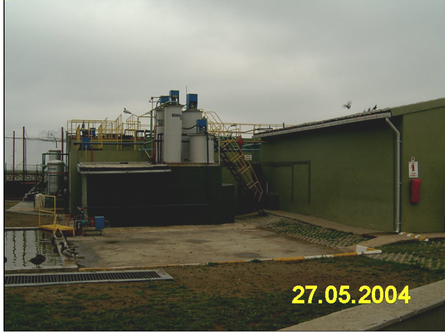
Şekil 2. Bir tanker terminali atık alım ve arıtma tesisi
