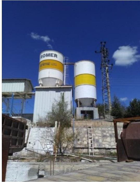
Şekil 3.16. Tesiste arıtma sisteminin görüntüsü
