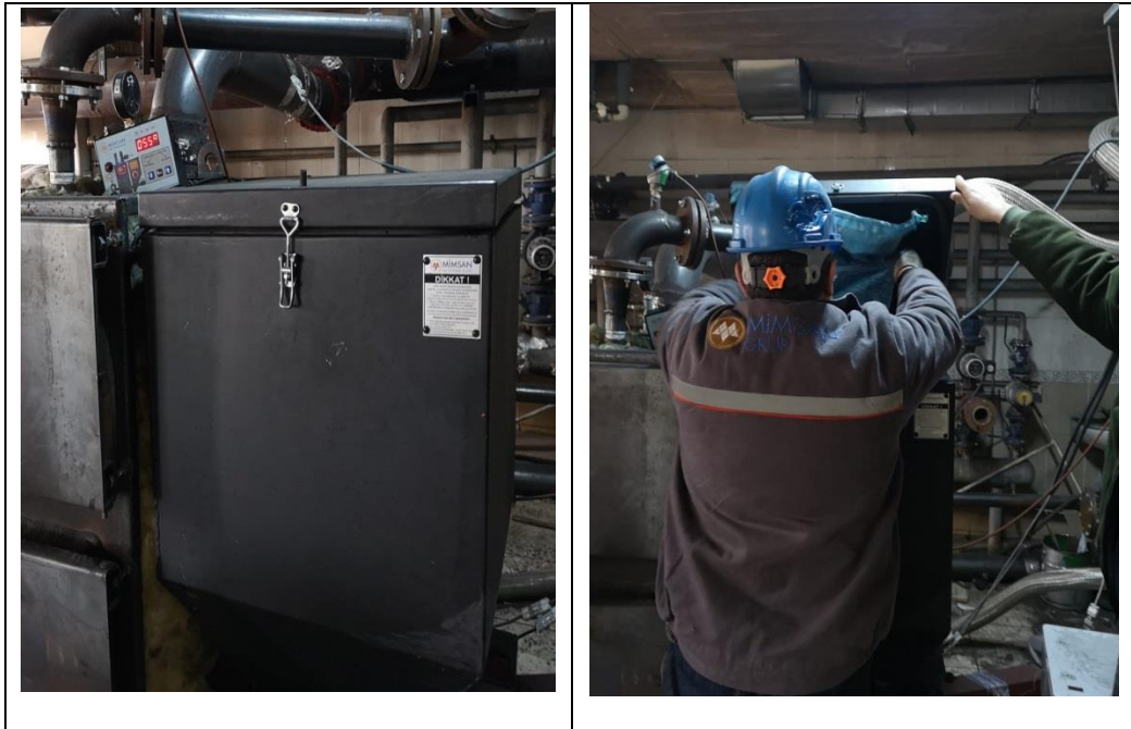
Şekil 3.7. (a)Bunker (b) Bunkere kömür yüklenmesi
