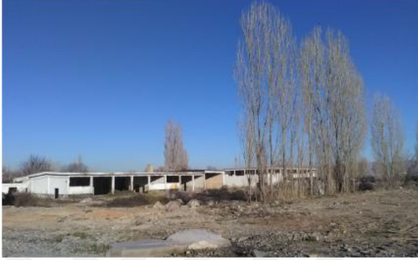
Őekil 4.44. Bakımı yapılmamıŐ atıl binalar.
