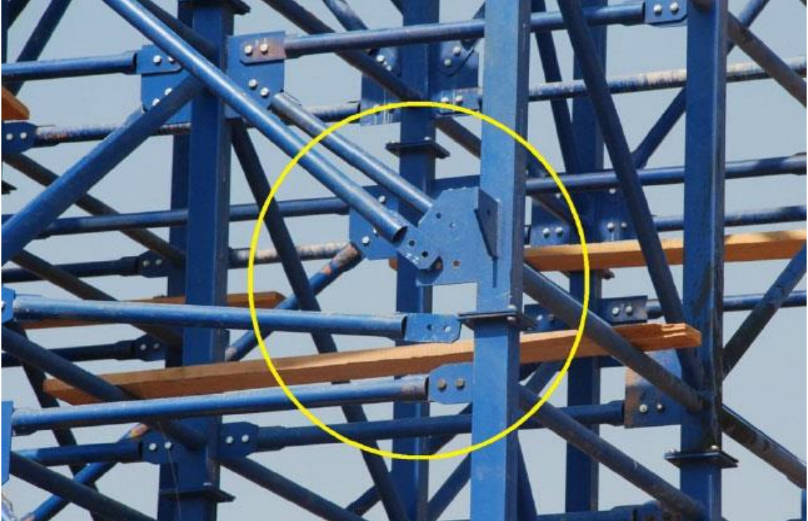
Resim 5a. Viyadük İnşaatında Dört İşçinin Ölmesine Sebep Olan İş Kazası
