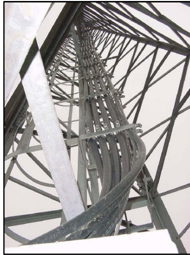
Şekil 2.13 : Kule antenine bağlanan besleme kablosu [21].
