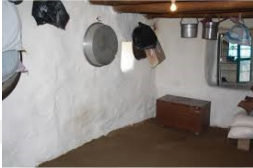
Resim 1: Asbestin yalıtım amacıyla evlerin duvarlarında kullanımı
