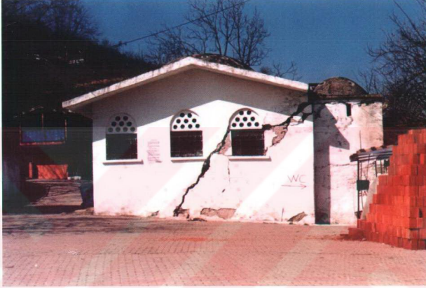
Şekil 4.7 Örcün Fayı üzerinde gözlenen hareket nedeniyle Sultanbaba Türbesi civarındaki hamamda meydana gelen hasar.
