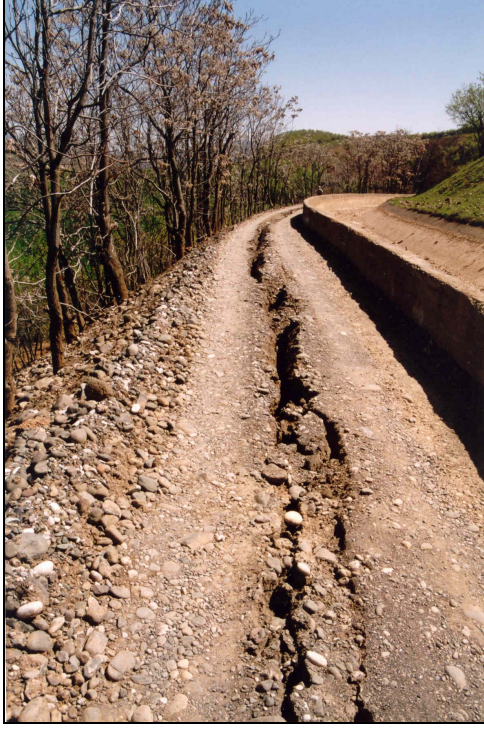
Şekil 7.12. Göynük Vadisi Ilıcalar Beldesi-Beyaztoprak Mahallesi arasındaki sulama kanalı boyunca uzanan dolgu yoldaki gerilme çatlakları.
