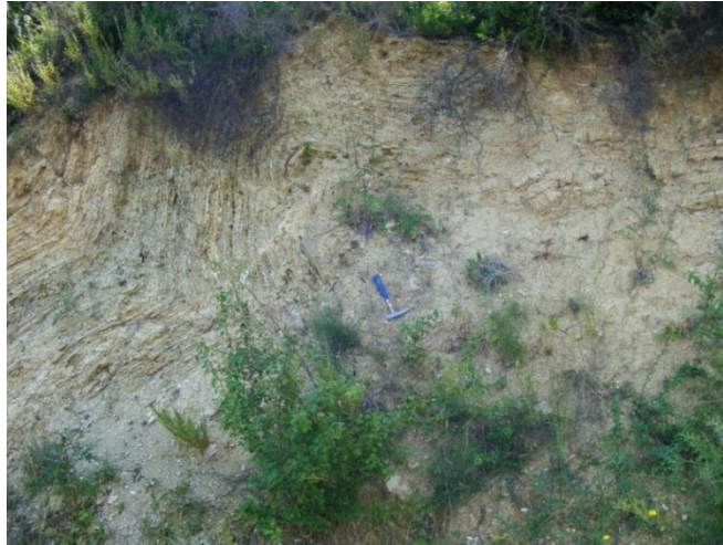
Şekil 4.4: Balıklıdere Mevkii, Sebenoba formasyonuna ait kiltası tabakaları arasında oluşan kırırım. K20^0D doğrultulu tabakanın eğimi 14^0KB .
