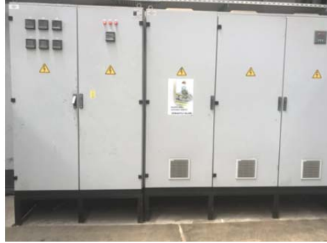
Şekil 5.33. Elektrik panosu önü yalıtkan paspas uygulaması
