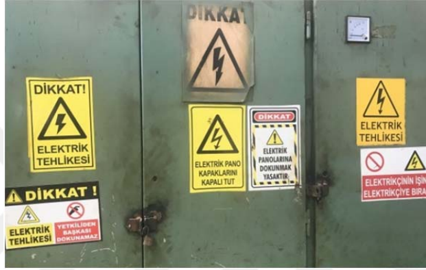
Şekil 5.31. Elektrik panosu uyarı levhası
