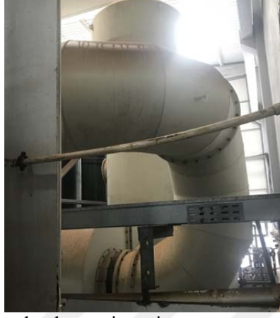
Şekil 5.28. Galvaniz tesisi havalandırma sistemi
