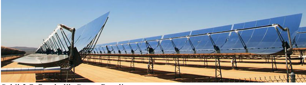
Şekil 3.7. Parabolik Güneş Paneli
