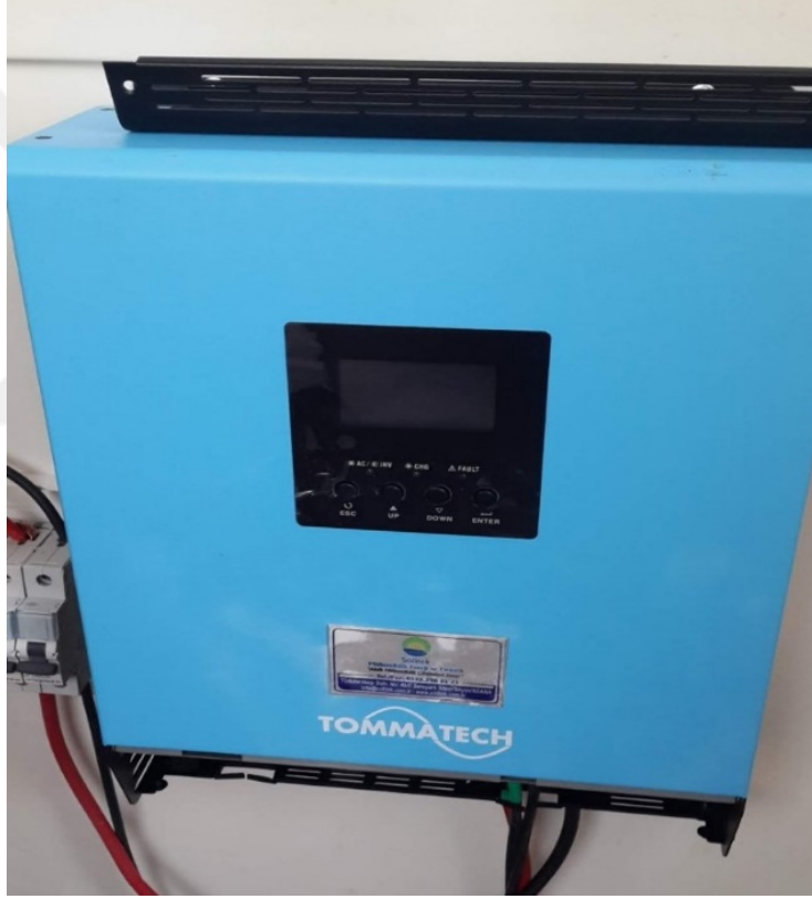
Şekil 3.24. Tommatech marka inverter
