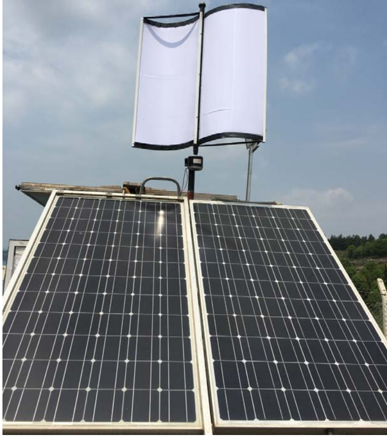
Şekil 3.33. Kurulumu tamamlanan hibrit enerji sistemi görüntüsü
