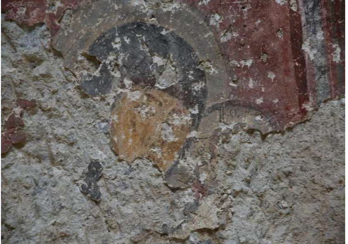
Foto. 115- Erdemli Kilise Camii, apsis duvarı, detay. (M. Gülyaz arşivinden)
