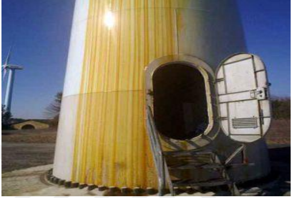
Şekil 4. Yağ sızıntısı, Clyde[26].
