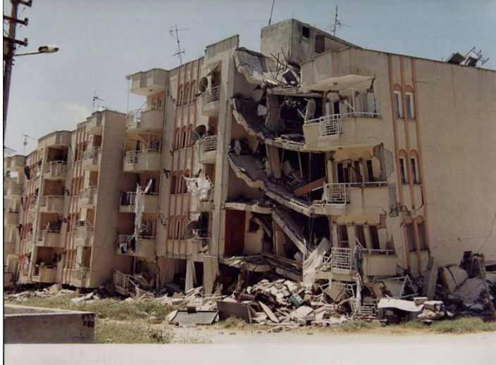
Şekil 2.8 : Adana Depreminin Yapılarda Meydana Getirmiş Olduğu Hasar [22].
