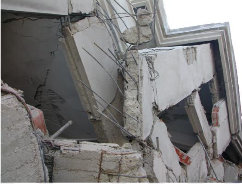
Şekil 4.3 : Kolon-Kiriş Bağlantı Noktalarındaki Zayıflığa Bir Örnek [42].
