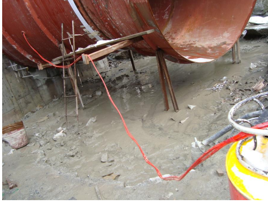
Şekil 7.19. Gama ışın kaynağı kumanda kablosu.
