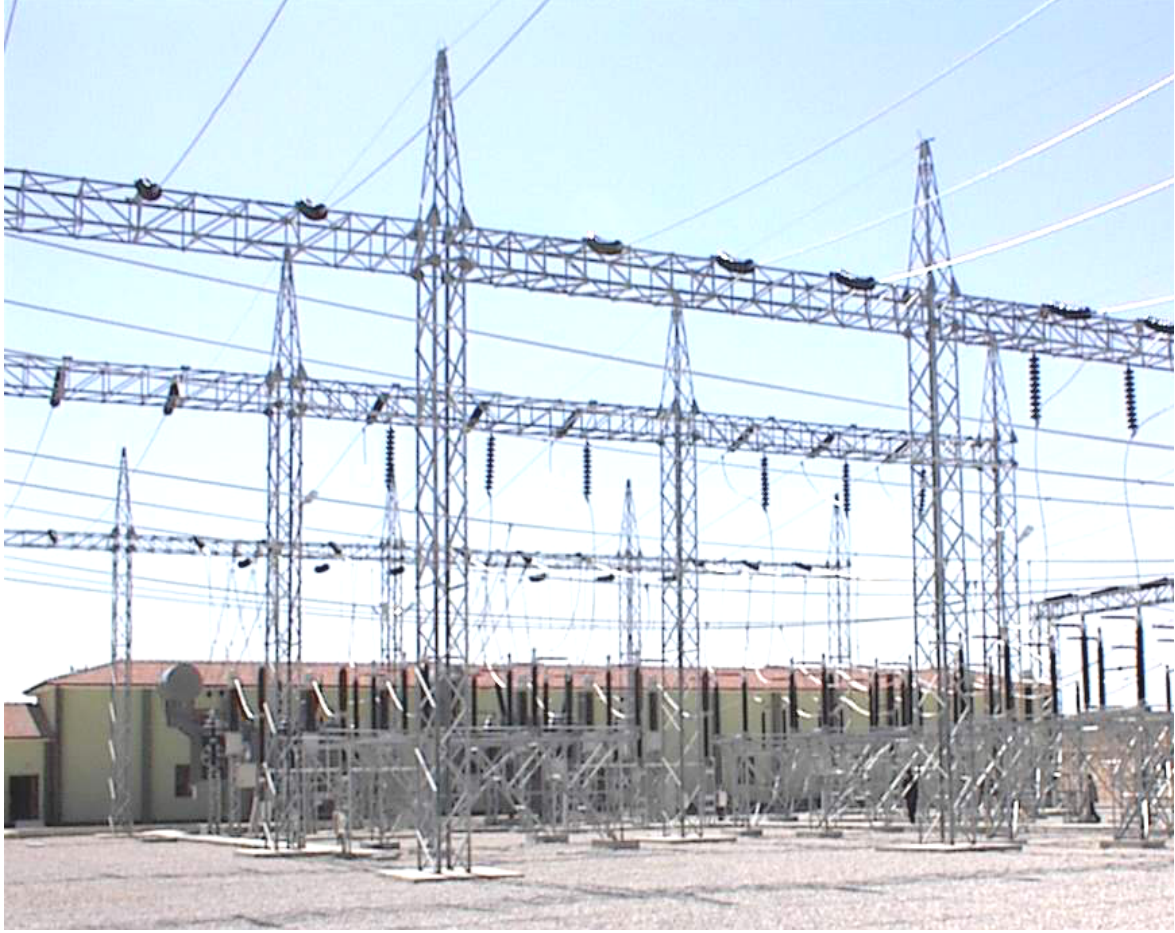
Şekil 4.26 : Karaman OSB şalt sahası
