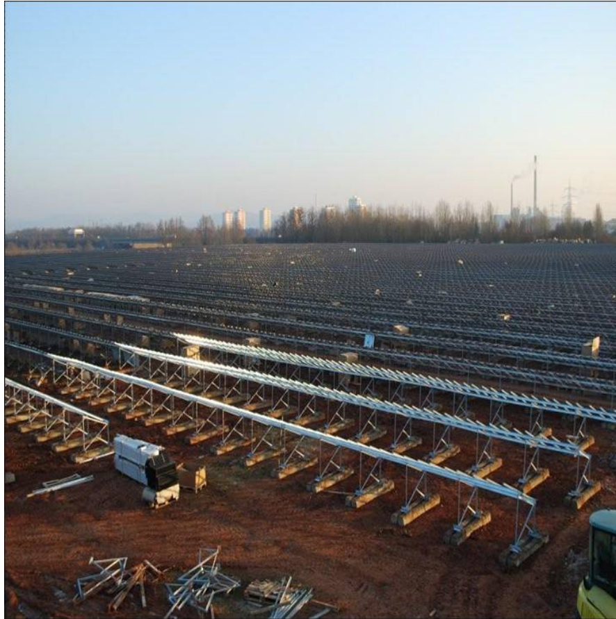
Şekil 3.38 : Beton bloklar ve galvaniz çelik güneş paneli montaj yapısı
