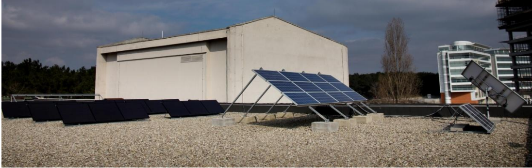
Şekil 4.10 : İTÜ Enerji Enstitüsü güneş enerjisi üretim sistemleri.
