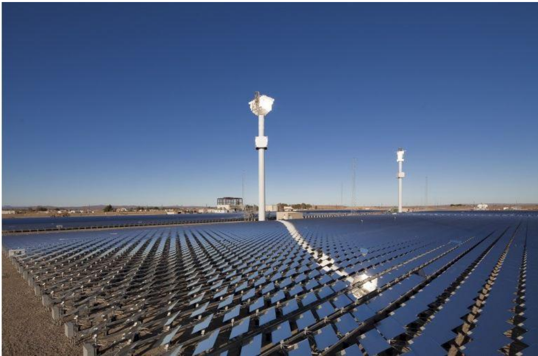
Şekil 1.11: Güneş güç kulesi [13].
