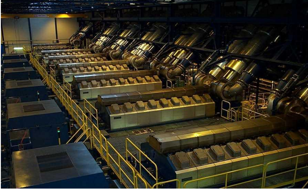
Şekil 3.2: Santralin motor dairesinden bir görünüm (Wartsila Corp., 2001)
