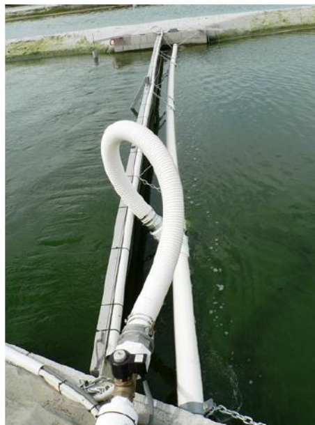
Şekil 5.11 : Christchurch atık su arıtma tesisindeki CO 2 besleme ünitesi [92].
