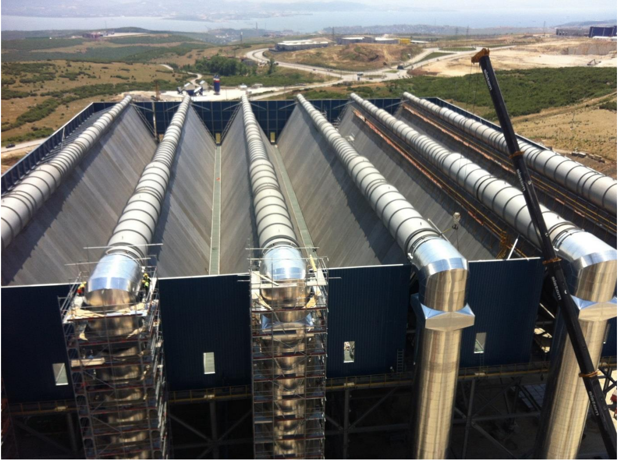
Şekil 4.10 : A yapılı hava soğutmalı yoğuşturucunun kuş bakış görüntüsü
