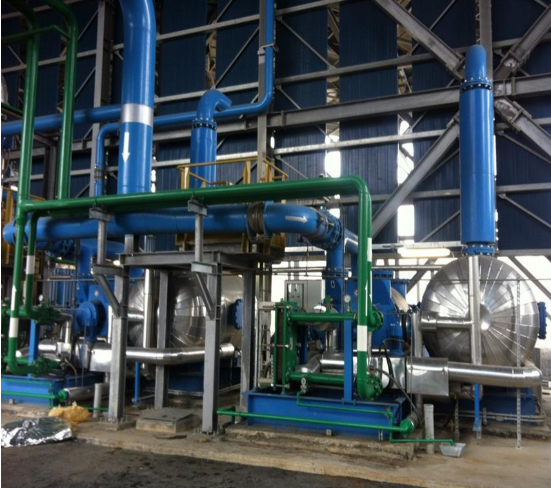
Şekil 4.16 : Tesiste yer alan 2 adet ‘‘Hogging’’ vakum ekipmanlarını resmi Havanın boşaltımı, sıvı halka tipi motorla çalışan vakum pompalarıyla gerçekleştirilmektedir.
