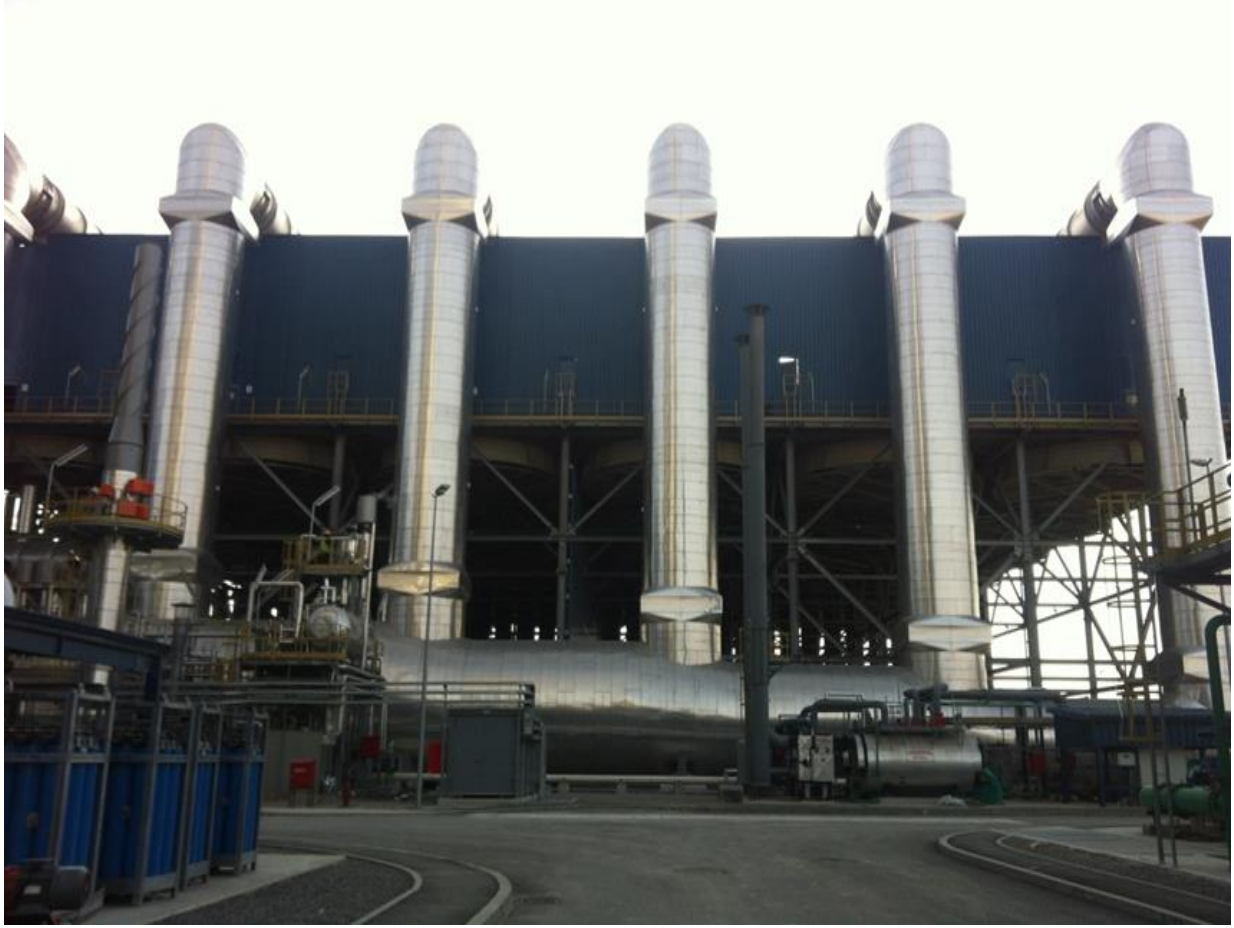
Şekil 4.9 : Hava soğutmalı yoğuşturucusunun genel görüntüsü
