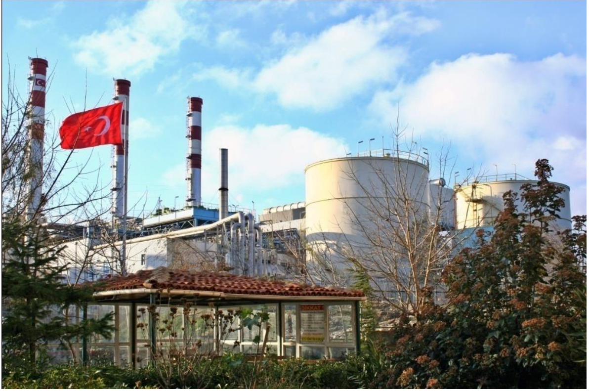
Şekil 4.26 : Esenyurt termik santrali.
