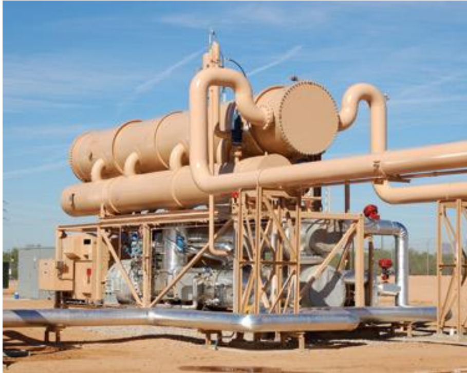
Şekil 2.3: Saguaro Güneş Enerjisi Santrali'nde kullanılan güç bloğu [31].
