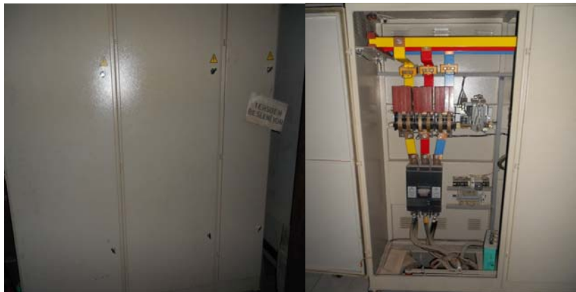
Şekil 5.1: 1000 kVA Trafo bölümü ana dağıtım panosu.
