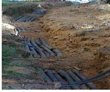
Şekil 3.17 : Kanal kapatılmadan önceki kuyu ve laboratuvar arasındaki boru hatları.
