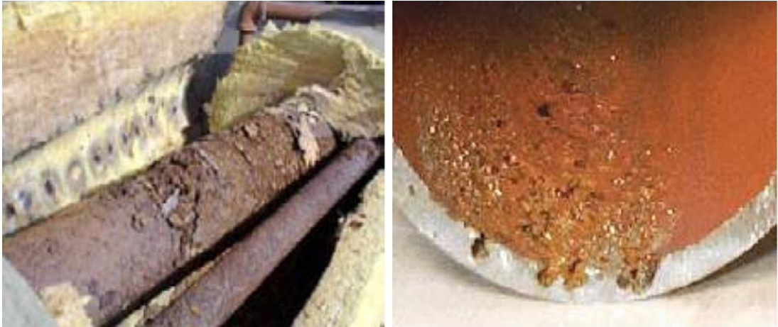
Şekil 4.1 : Çelik borularda korozyon örnekleri.
