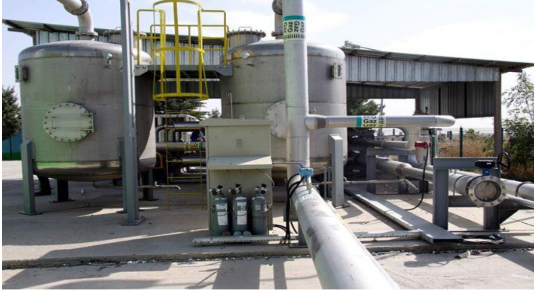
Şekil 6.3: Gaziantep Şahinbey Elektrik Üretim Tesisi [24].
