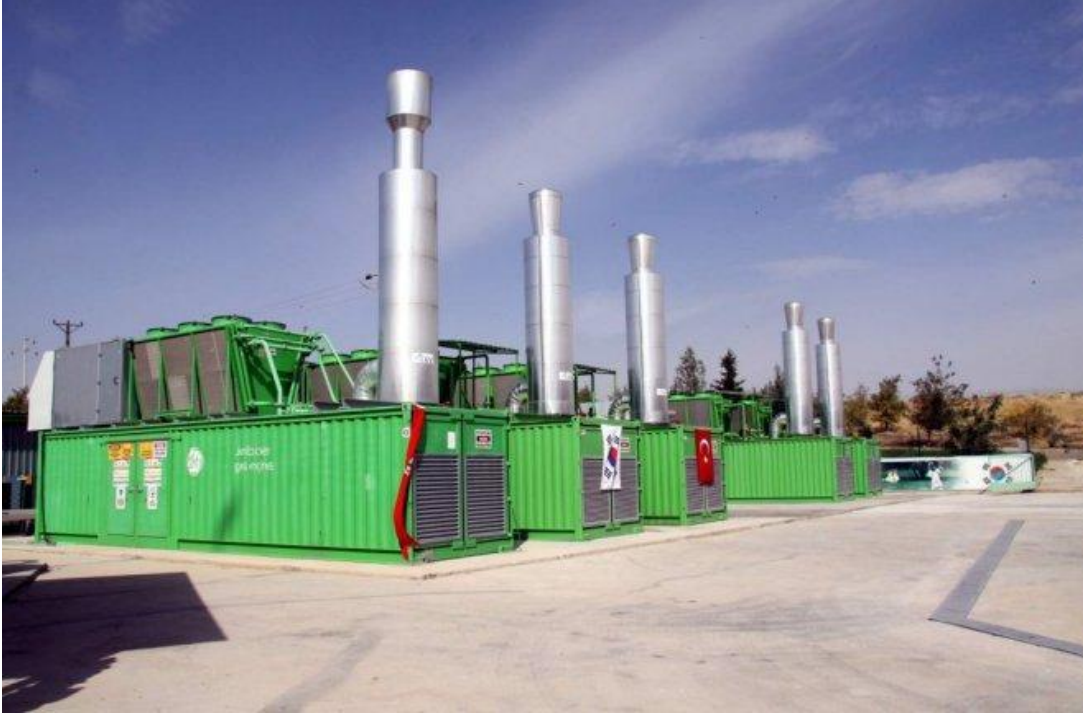
Şekil 6.10: Gaziantep depo gazından enerji üreten tesisin görünümü [34].
