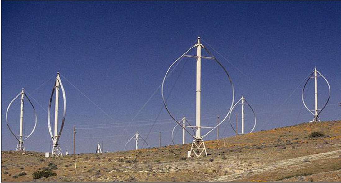
Şekil 3.7 : 1986 Yılında Devreye Alınan Tehachapi Pass Darrieus Tipi Rüzgar Santrali.
