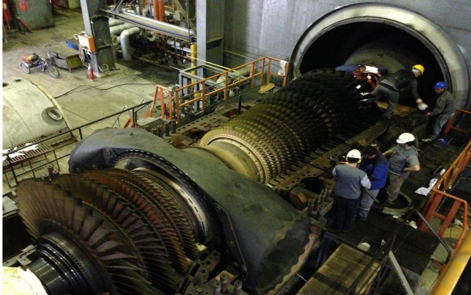
Şekil 4.4 :Gas türbin yatakları.
