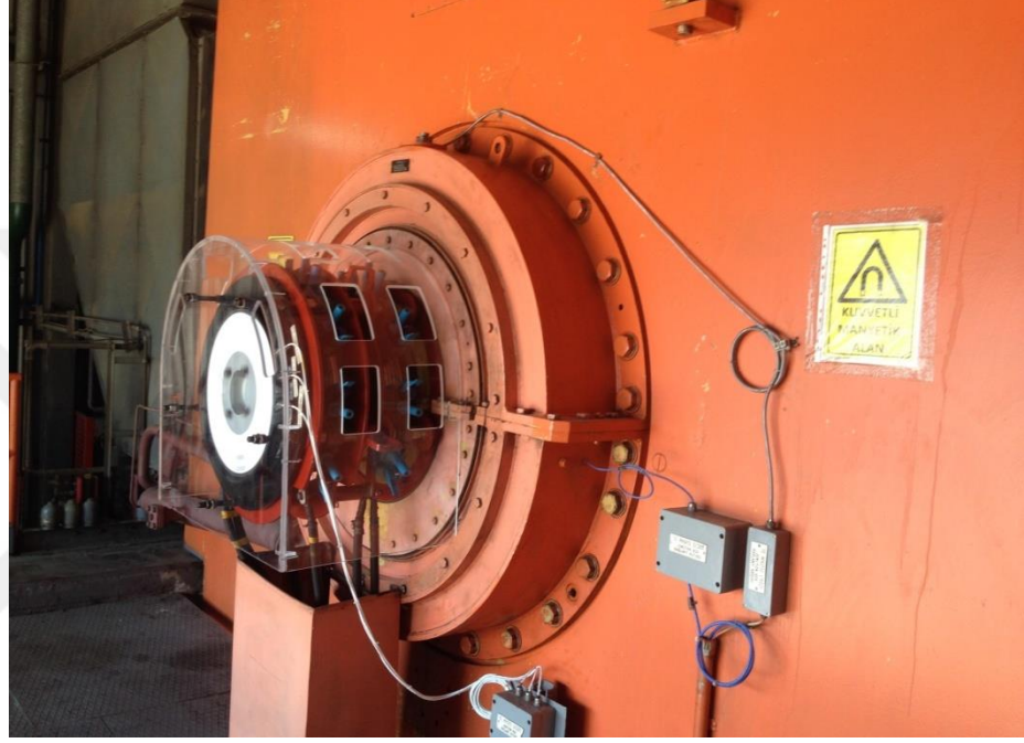
Şekil 4.6 :Gas türbini generatörü.
