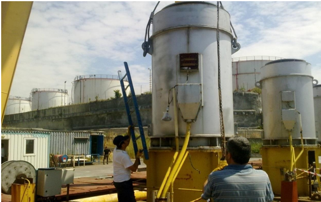
Şekil 4.12 :Soğutma suyu pompaları.
