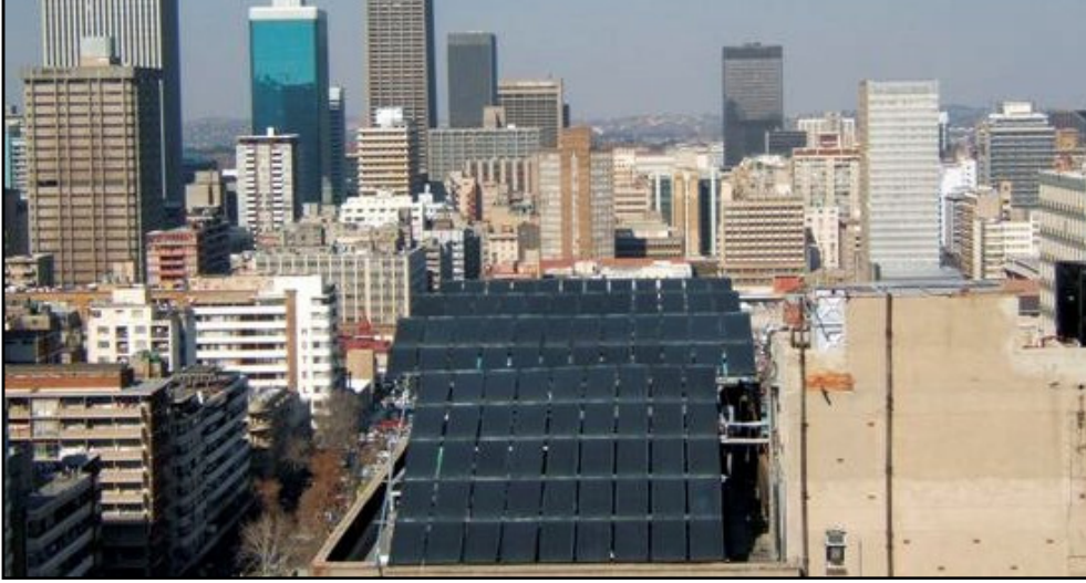
Şekil 1.48 : Güney Afrika’da günlük 200 m 3 evsel sıcak kullanım suyu için ısıtıl güneş enerjisi sistemi örneği [60].
