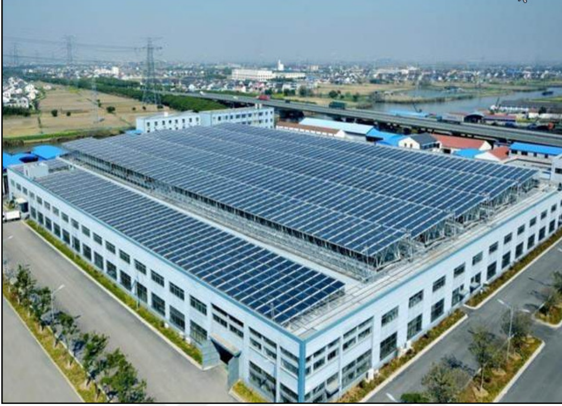
Şekil 1.52 : Jiangsu Printing and Dyeing, Çin 9.000 m 2 alana kurulu proses suyu ön ısıtma amaçlı ısı güneş sistemi örneği [64].
