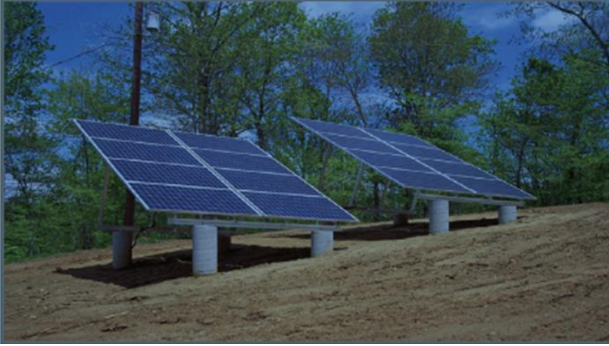
Şekil 3.18: Arazi kurulumu fotovoltaik sistem örneği.
