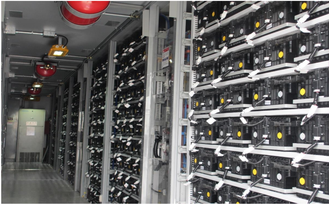
Şekil 3.14: Fotovoltaik sistemde üretilen enerjiyi depo eden bataryalar.
