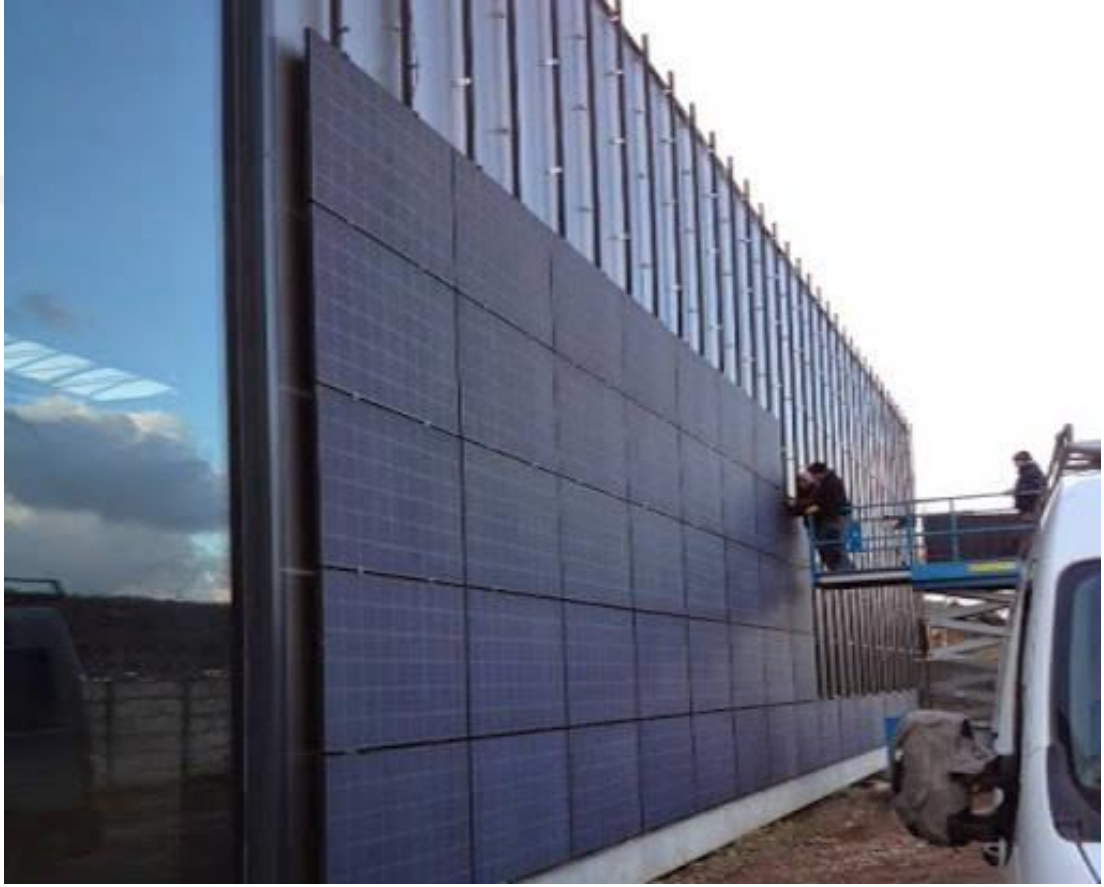
Şekil 3.7 : Bina cephesi üzerine montaj yapılan FV sistem.
