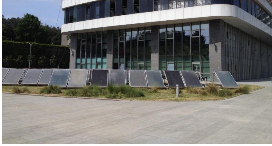
Şekil 1.16 : Arı 3 binasının bahçesinde kurulu güneş enerjisi sistemi.
