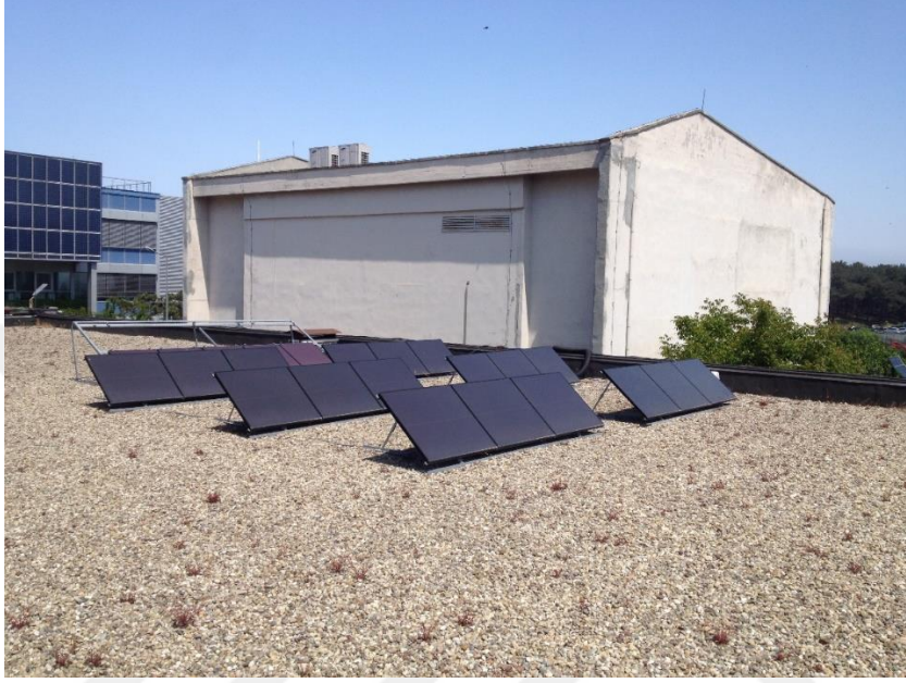
Şekil 1.14 : İTÜ Enerji Enstitüsü çatısında kurulmuş olan FV sistem.
