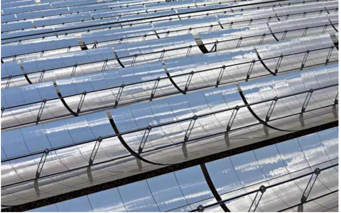
Şekil 2.2: Parabolik oluk tipindeki Andasol Enerji Santrali, İspanya [7].
