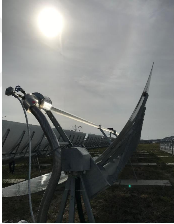
Şekil 3.12 : Parabolik oluklu kolektörün alıcı ekipmanı ve borulaması, saha fotoğrafı.
