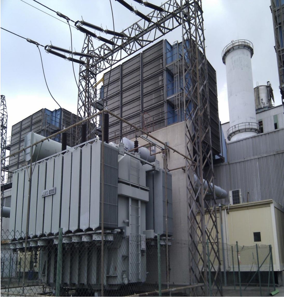
Şekil 2.2 : Çok kademeli hava filtresi ve trafo.
