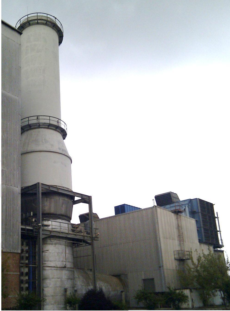
Şekil 2.5 : Gaz türbini bacası.
