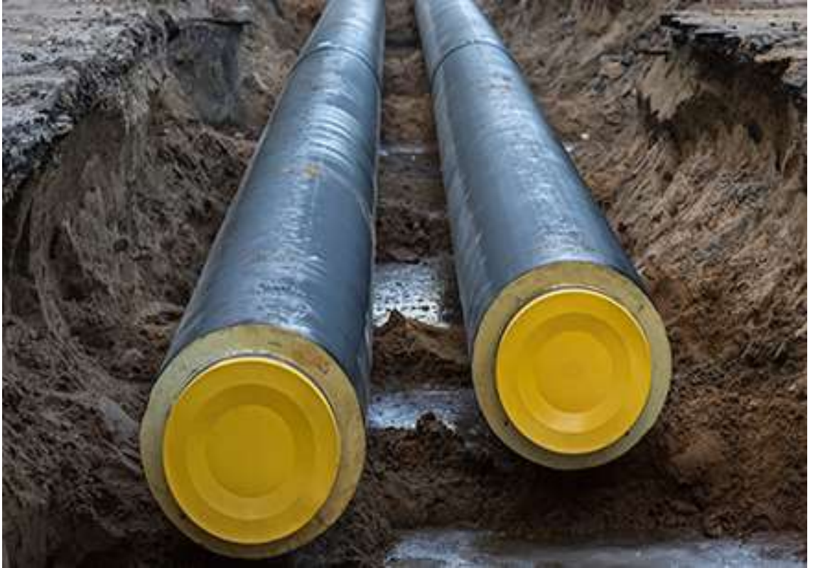
Şekil 1.42 : Bölgesel Isıtma Sisteminin Yalıtımlı Dağıtım Boruları[44].
