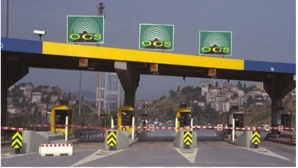
Şekil 4.5. Elektronik ücret toplama sistemi
