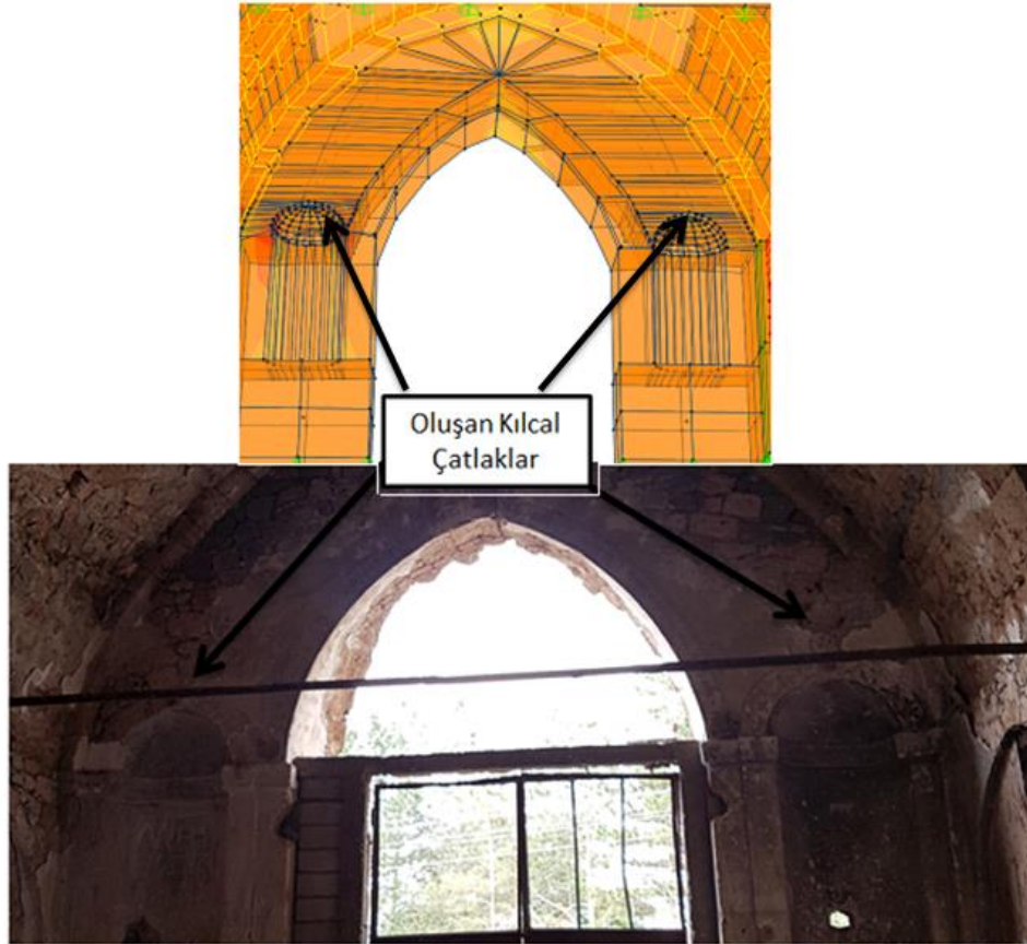
Şekil 4.2 Çekme Gerilmeleri Nedeniyle Oluşan Kılcal Çatlaklar
