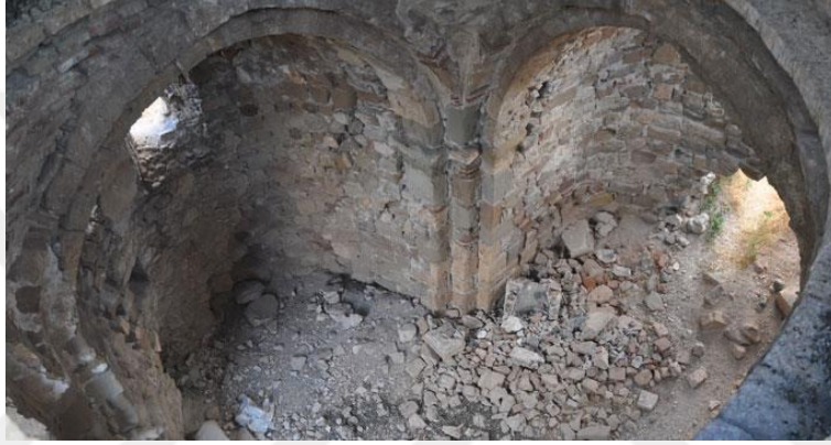
Şekil 3.16. Patlatma etkisi ile hasar gören yığma yapı
