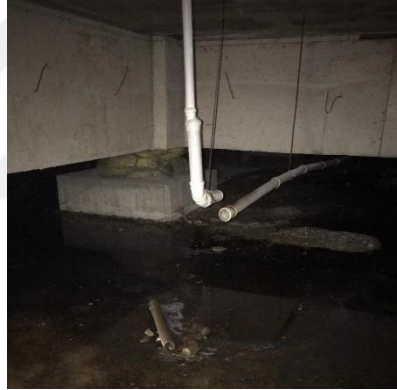
Şekil 3.29 İzolatör katı su boruları
