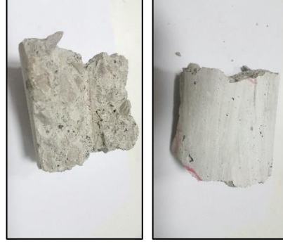
Şekil 4.80 KNB grubu numunesi içi çatlak detayı
