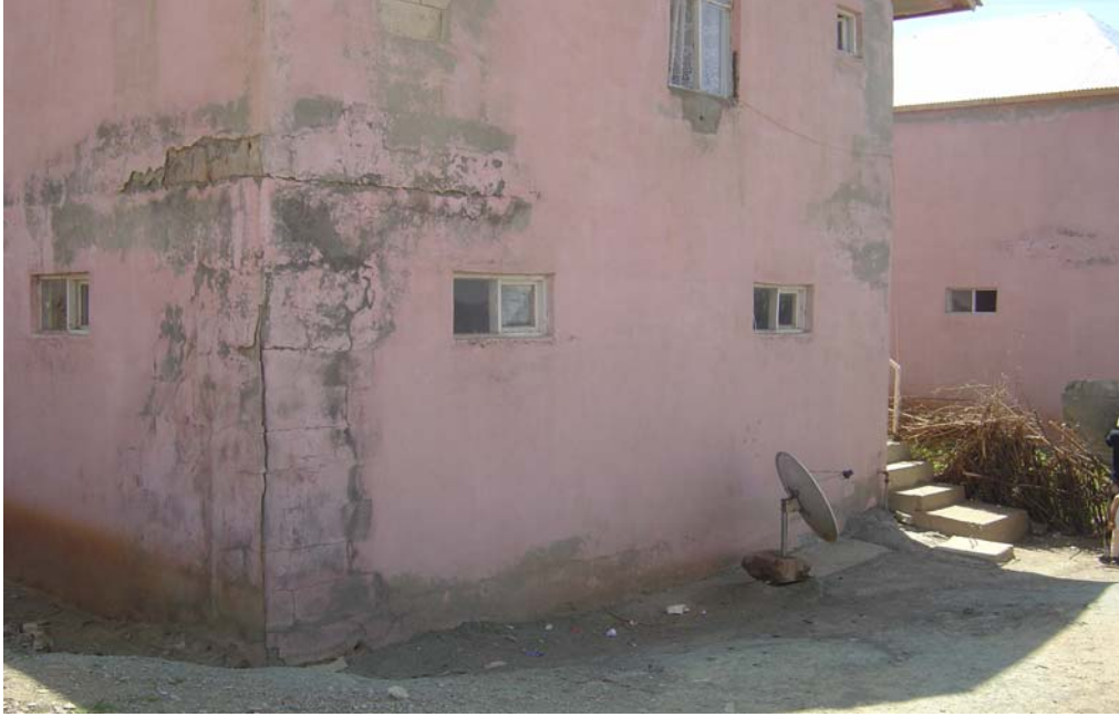
Ek: 4.17. Duvarda su sızıntısı
