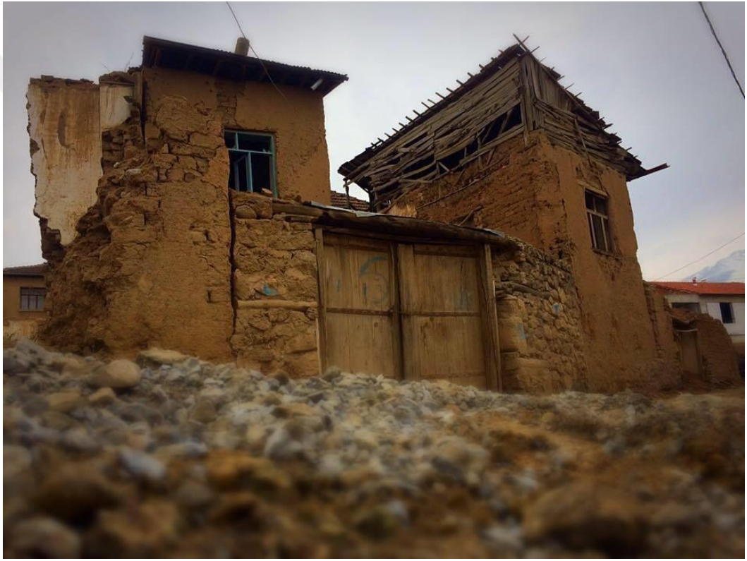
Fotoğraf 4.2. Yıkık Kerpiç Ev
