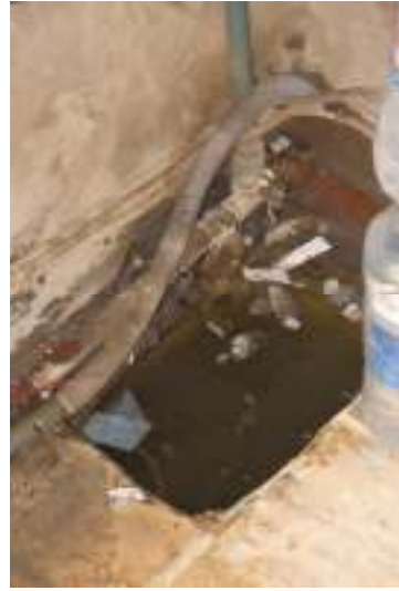
Resim 6.112. Çay Ocağındaki Su Tesisatı Detayı.
