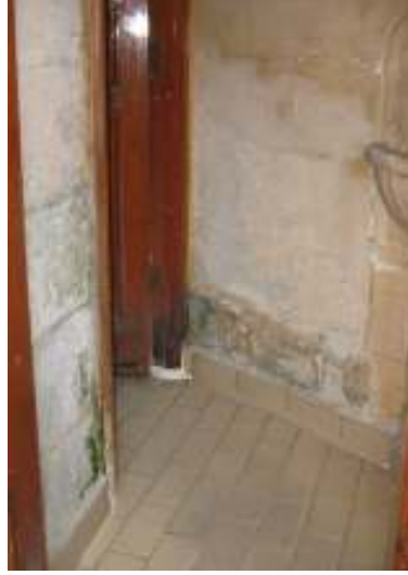
Resim 6.110. Tuvaletlerin Duvarlarındaki Bozulmalar.
