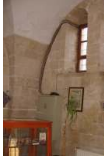
Resim 6.83. Giriş Bölümündeki Elektrik Panosu.
