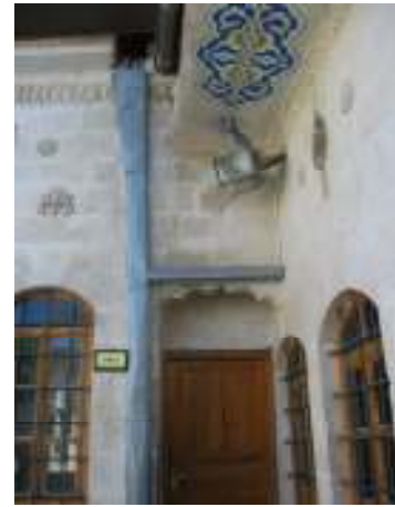
Resim 6.76. Elektrik Kablo Kanalları.
