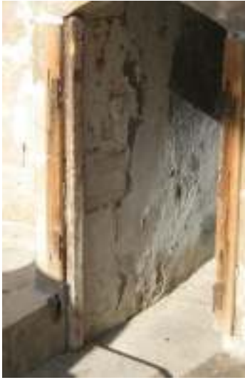
Resim 6.111 . Kiler Duvarlarındaki Bozulmalar.
