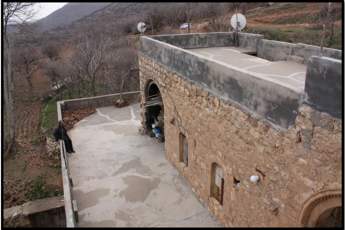
Resim 7.2.b: Damı Beton Şap İle Kaplanmış Birkitül Cemel Kasrı
