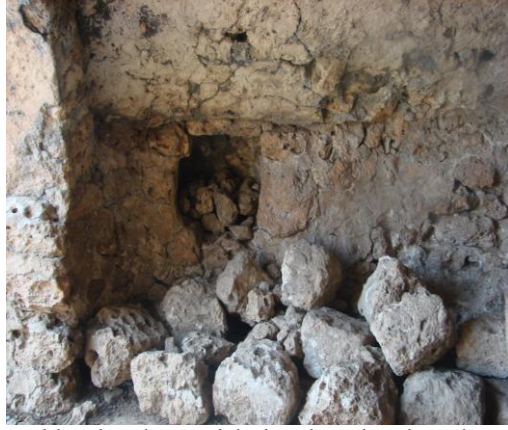
Doldurulan duvar nişleri ve bozulan duvarlar
